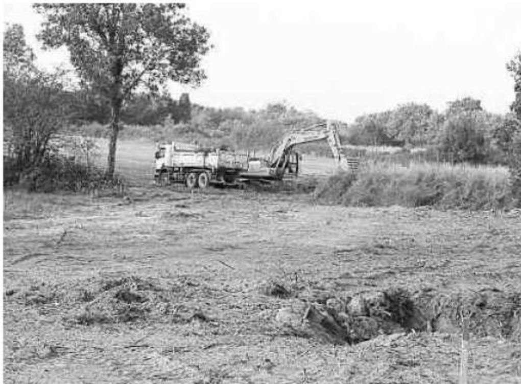
Les travaux du parc d'entreprises de la Folaine ont démarré. La livraison est prévue pour le printemps 2010.
